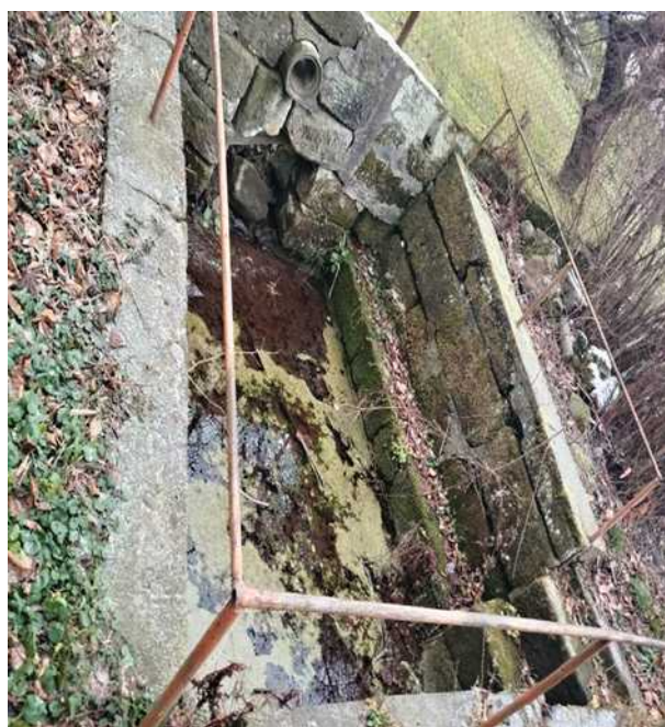
nádrž na vodu
