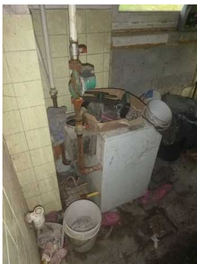
plynový kotel Viadrus - odpojeno
