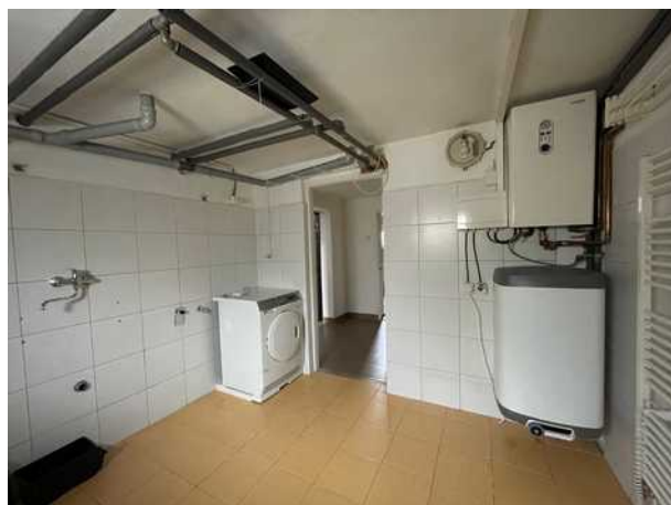
technická místnost v 1.PP
