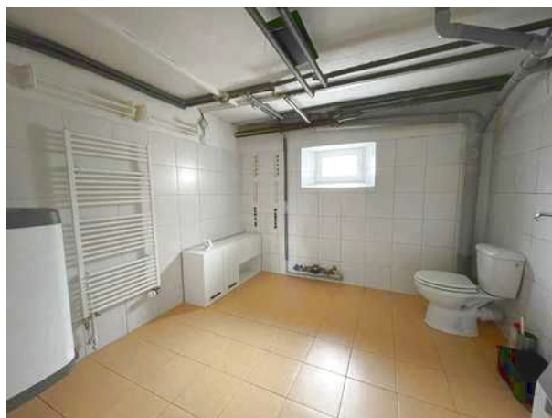
technická místnost v 1.PP
