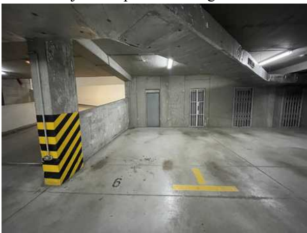
garáž - stání č.6, vstup do sklepa
