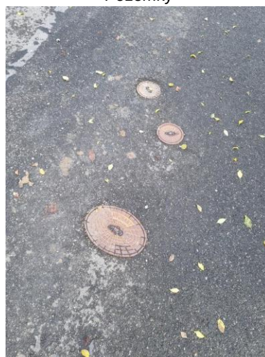
Přípojný bod vody
