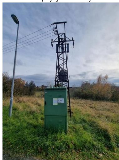
Alt. přípojný bod elektro
