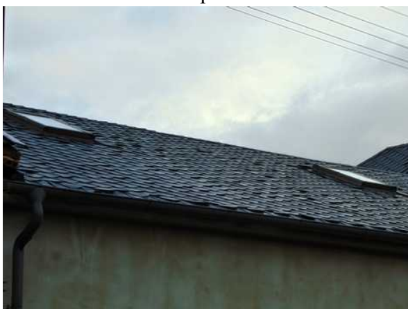
poškozená střešní krytina na RD
