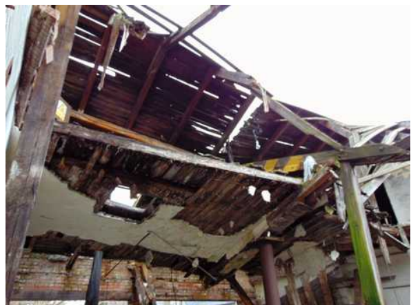
truhlářská dílna - zřícená střešní konstrukce
