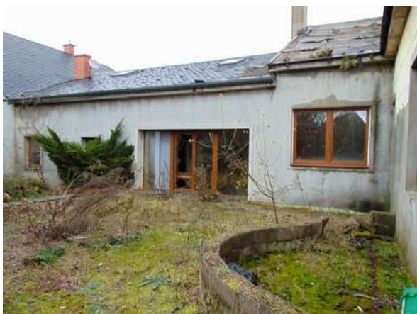
obytná část - poškozený vstup
