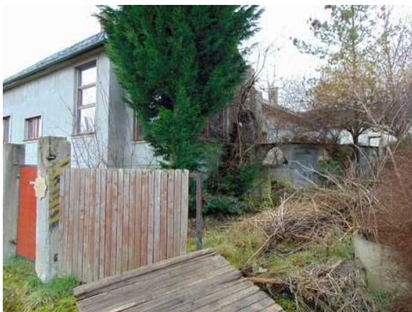
hlavní vstup k RD - vyvrácené vrata
