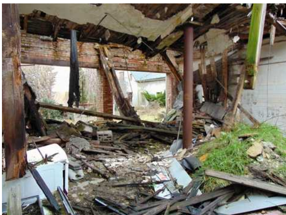
truhlářská dílna - zřícená střešní konstrukce
