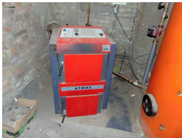
kotel na tuhá paliva a akumulční nádrž
