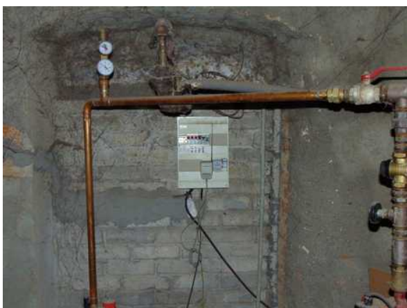
rozvody otopné soustavy
