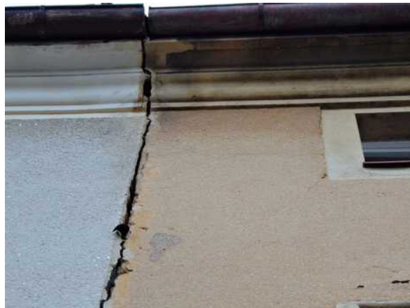
trhlina mezi domy
