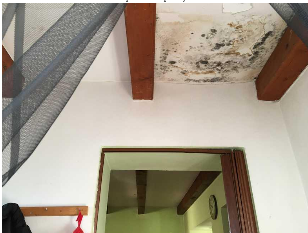
1.NP plíseň na stropě
