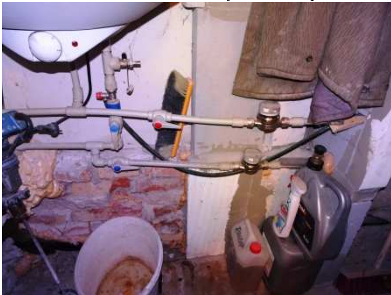
bojler a měření pod schodištěm
