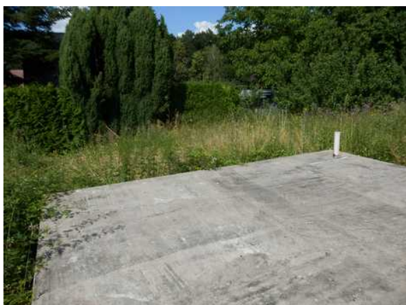
Oceňované pozemky - betonová deska na st.p.č. 1227 - pohled severní
